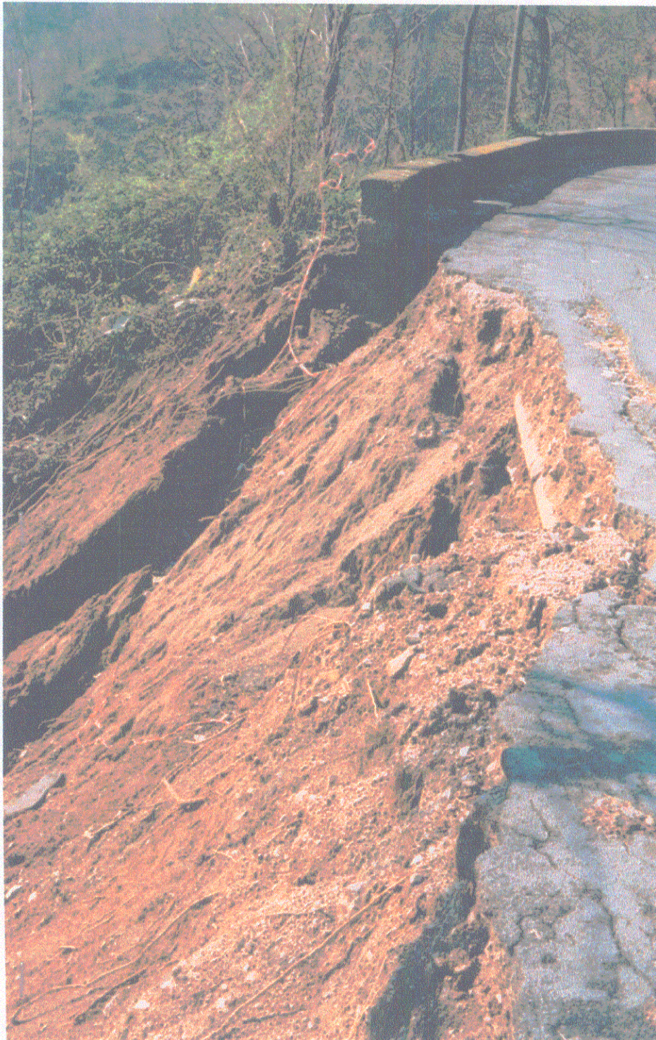
Fig. 2.3b - Nicchia di frana in Loc. Avvocatella (Cava Dei Tirreni). S.P. 289 - km 2
